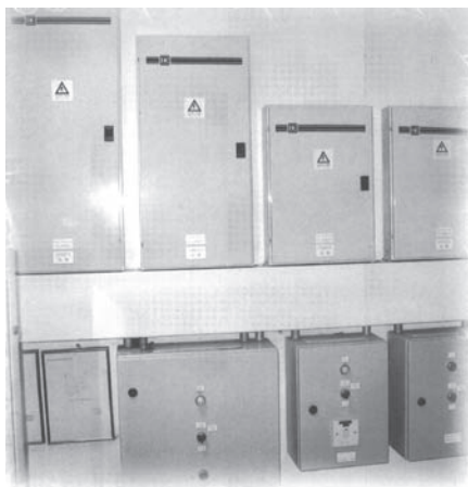
圖2-4：現代配電設備
