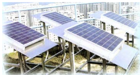
圖5-1: 太陽能光伏發電板
