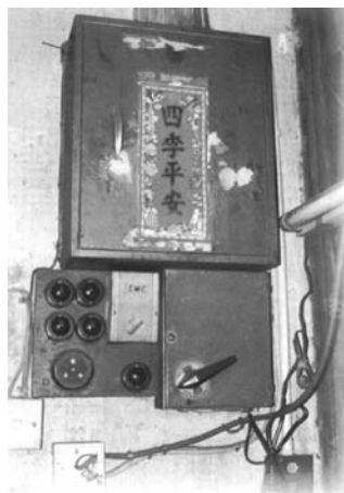
圖2-1：舊式家居電力裝置
