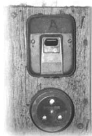
圖1-3：舊式電力設施
