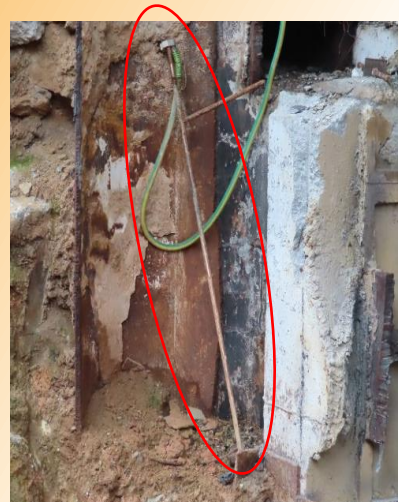
發電機沒有接地
