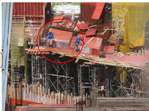
樓邊沒有設置足夠護欄及踢腳板
