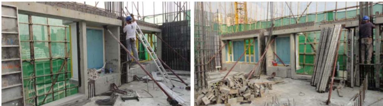
Figure E.11. Precast Elements
