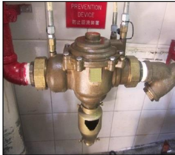
為使政府食水供應系統不受污染，擁有人須安裝符合標準的防止回流裝置
